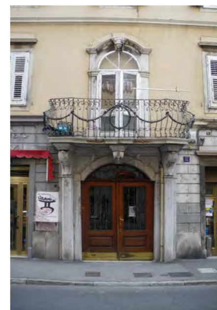
via Roma 17 - particolare dell'ingresso e soprastante poggiolo con parapetto in ferro lavorato a motivi ornamentali
