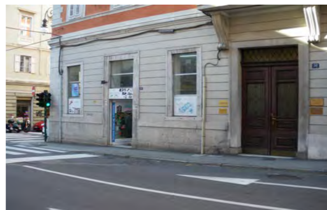
Alterazione del pianoterra
