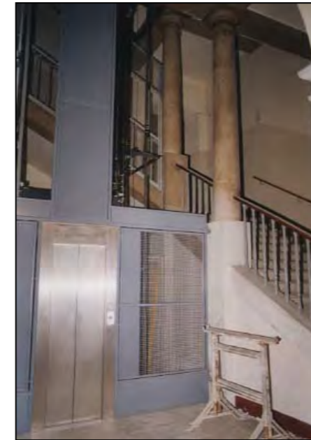
L'impianto dell'ascensore installato nell'ampio fuso di risulta della scala (fotografia del 2000)
