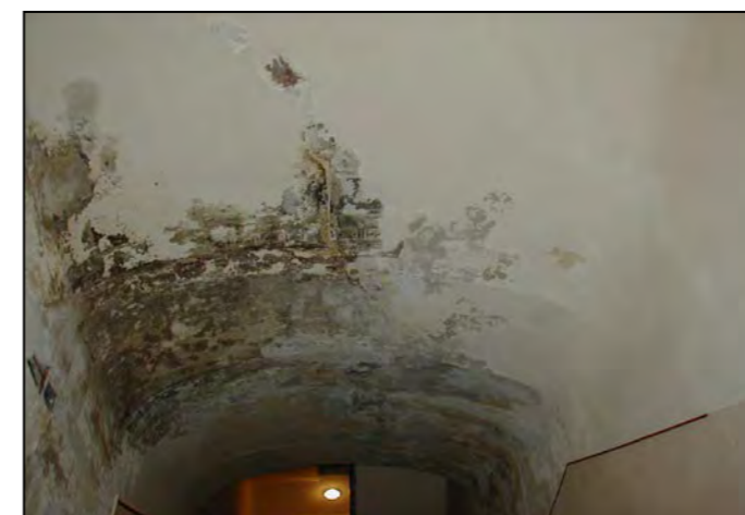
Infiltrazione su volta atrio
