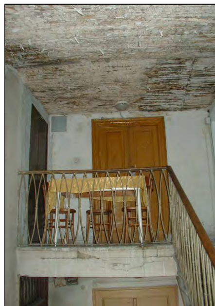
Degrado su pareti interne
