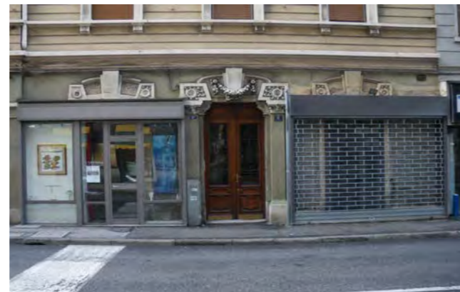
da notare l'inserimento dei rivestimenti metallici che alterano la scansione e il ritmo delle forature
