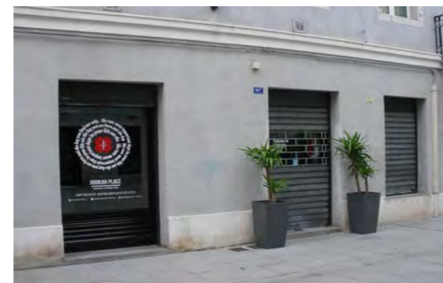
via XXX Ottobre 14 - particolare dei fori al piano terra
