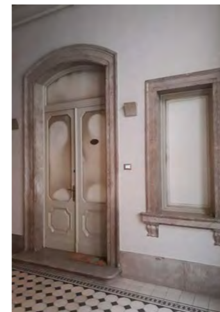
Atrio d'ingresso via F. Filzi 1 Fori locali adiacenti lato destro
