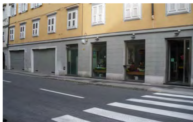
via Valdirivo 18 - alterazione dei fori al piano terra
