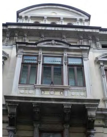
facciata su via Roma - particolare della balconata al secondo piano e del padiglione
