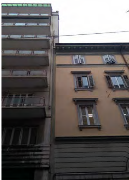
attacco lungo la via del Lavatoio con l'anagrafico 1526
