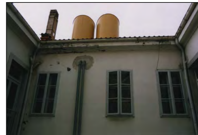
Particolare impianti tecnologici nel cavedio
