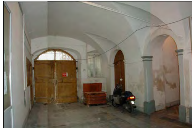
via C. Ghega 8 - atrio d'ingresso con visibili alterazioni sulla parte sinistra dove si interrompe la volta - immagine alla data del rilievo
