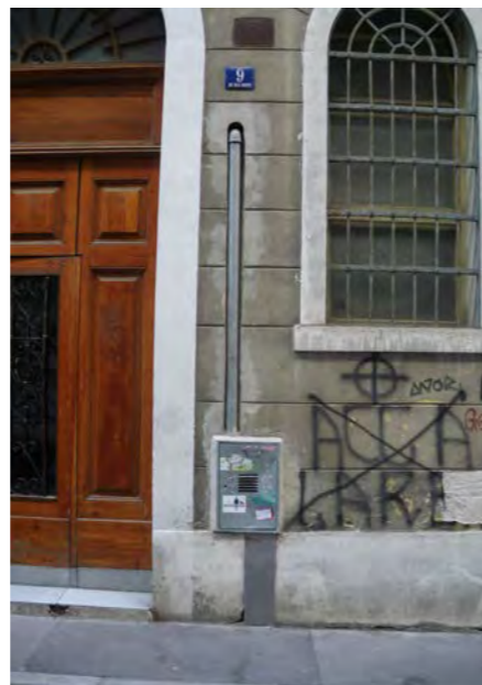
via della Sorgente 9 - particolare attacco adduzione impianto
