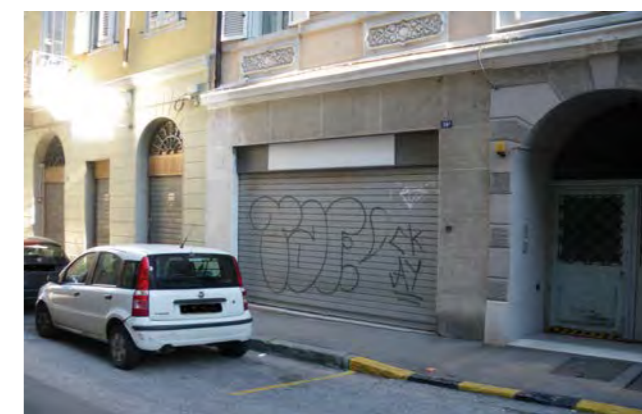
via A. e F. Nordio 14 - alterazione di una foratura al piano terra
