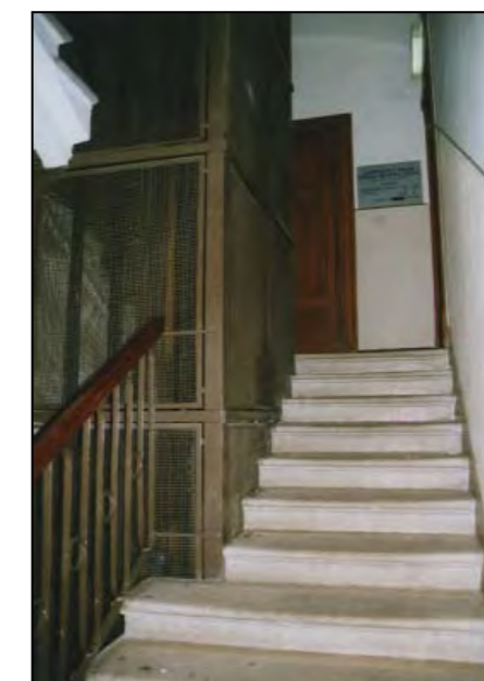
La rampa subisce un restringimento per il taglio apportato agli scalini dall'introduzione dell'ascensore
