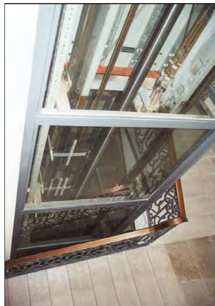
Particolare della cabina dell'ascensore
