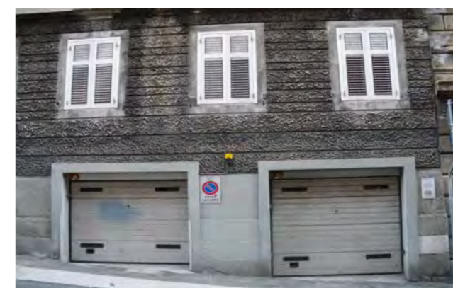
via Ginnastica 45 - alterazione dei fori al piano terra
