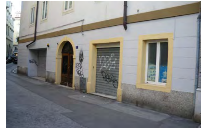
via della Sorgente 7 - alterazioni di forometrie al piano terra
