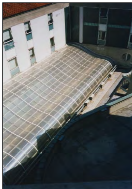
Particolare - galleria M. Besso, vista dall'alto (nota il grande spazio della ex corte)
