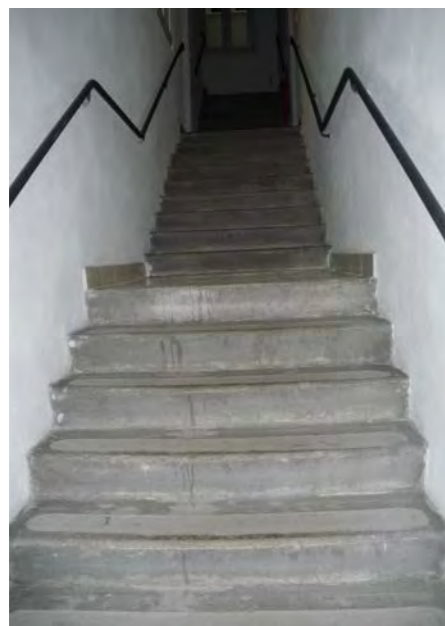
via A. e F. Nordio 11 - particolare dell'atrio e del corpo scala secondario
