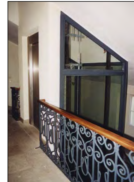
Particolare della cabina dell'ascensore
