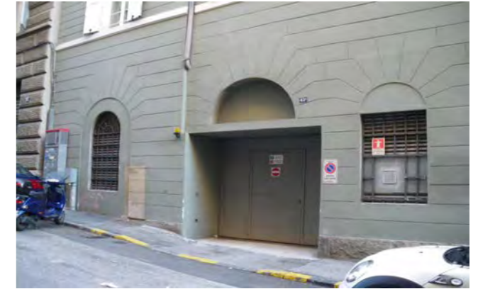
via F. Crispi 43 - alterazione di una forometria al piano terra
