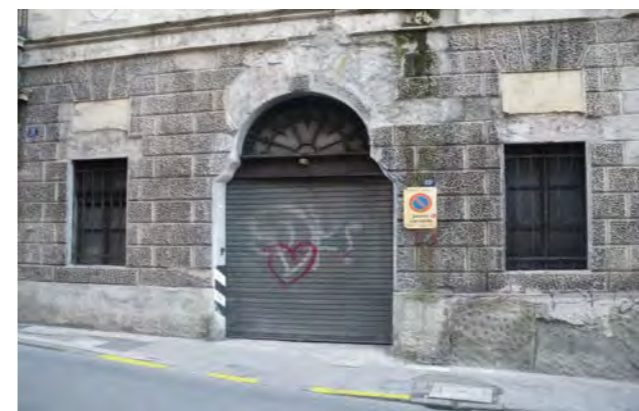
via G. Gatteri 13 - alterazione di un foro al piano terra
