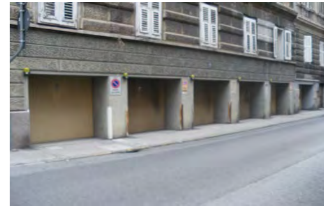
via A. Canova 10 - alterazione dei fori al piano terra
