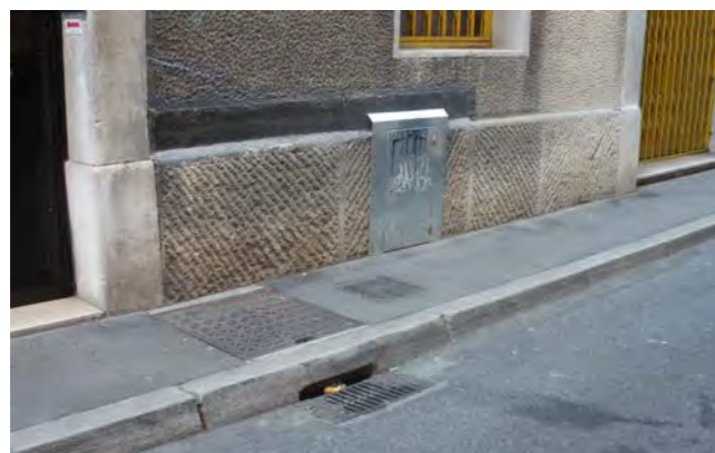
particolare basamento e attacco linea adduzione gas metano
