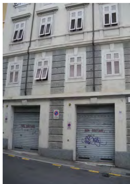
via G. L. Gatteri 30 - facciata su via C. e G. Stuparich - alterazione dei fori al piano terra
