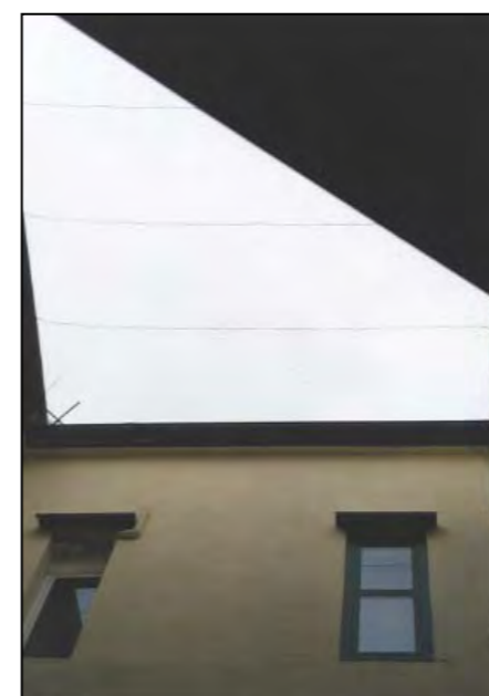
Particolare - rete su cavedio secondario a protezione dei piccioni.
