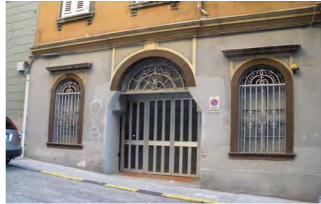
via F. Crispi 41 - alterazione di una forometria al piano terra
