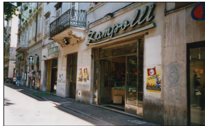
Particolare - pianoterra (nota : l'alterazione sia nelle forature, sia nel paramento murario nascosto dall' inserimento del marmo. Tutto senza alcun rapporto con il sovrastante prospetto).
