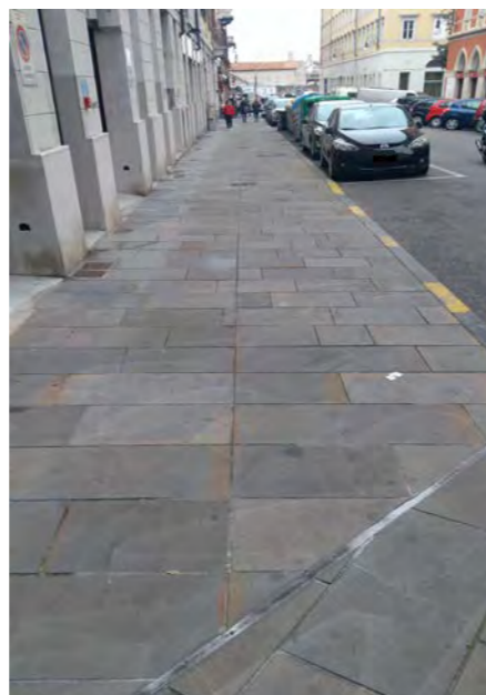
Pavimentazione di pregio lungo parte della via Economo ed il tratto finale di via Lazzaretto Vecchio
