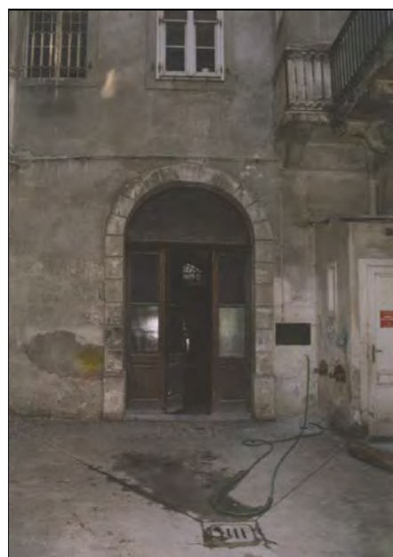
Corte interna (prima del risanamento)
