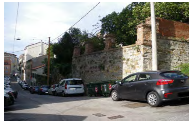
muro di contenimento e di cinta in blocchi di pietra sommariamente squadrate e posti in opera a corsi regolari con sopraelevazione in laterizio.
