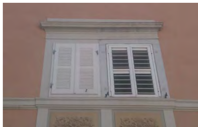
Prospetto su via della Cereria con finta persiana ("scuro") in malta - particolare
