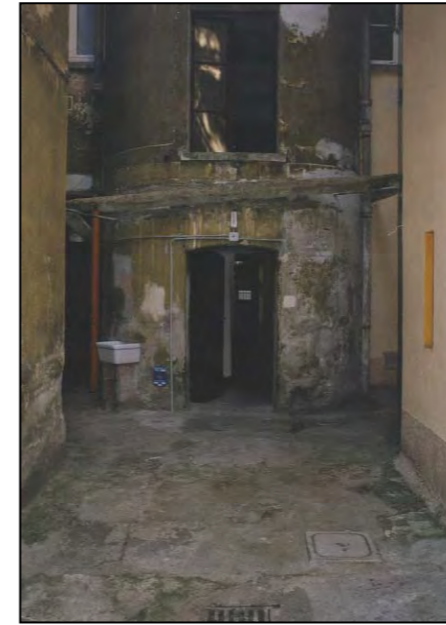
via Madonna del Mare 19 - facciata postica con pianerottolo del corpo scala aggettante e semicircolare (immagine alla data del rilievo)
