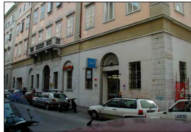
Alterazioni fori al piano terra
