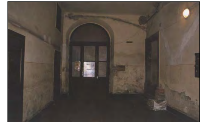
Androne d'ingresso (prima del risanamento)
