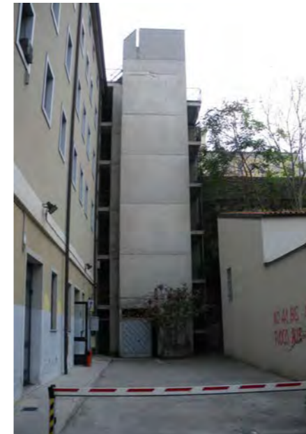
scala anti incendio e vano tecnico per l'anagrafico 4820
