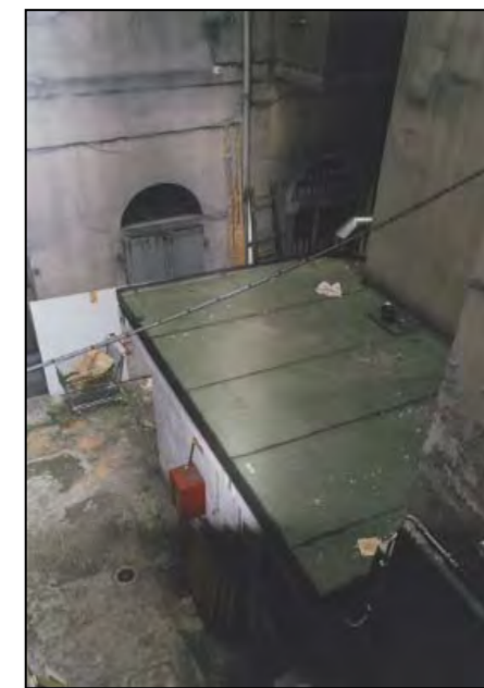
La centrale termica, corpo di fabbrica aggiunto nella corte
