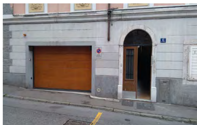
alterazione di forometrie al piano terra
