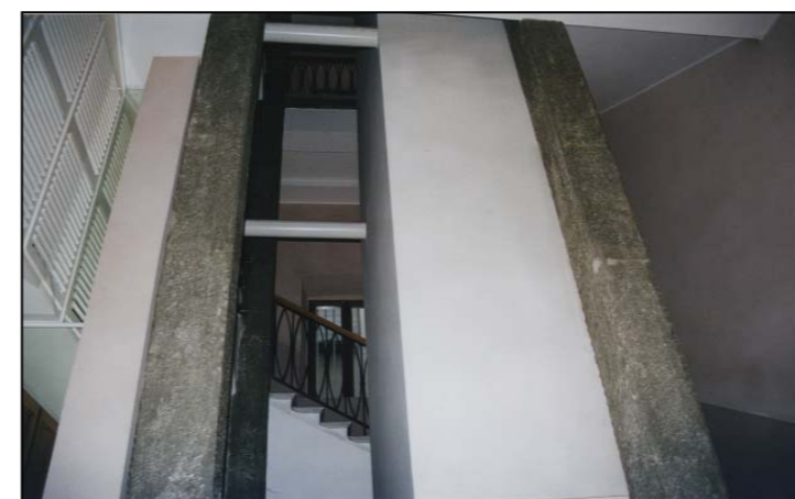
Inserimento di un ascensore tra i pilastri della scala a tre rampe ortogonali.
