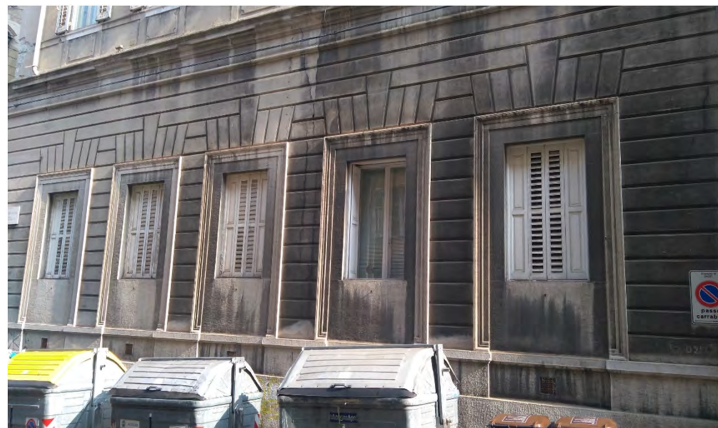
Serie di finestre incastonate in cornici e parziale muratura dei fori al piano terra (via Brunner 8 - 2019)
