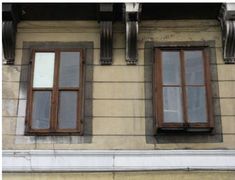
Serramento a "sburto" con ante bipartite. I battenti anteriori sono apribili verso l'interno sovrapponendosi alle ante fisse laterali. Si noti che anche il serramento contiguo nel piano della facciata non è del tipo a "sburto" (via Mazzini 11 - 2019)
