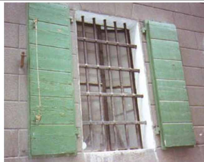
Cornice rettilinea in pietra intonacata e tinteggiata in continuità con il paramento bugnato. Gli elementi in pietra presentano scanalature in corrispondenza dei giunti delle bugne che risultano sagomate all'architrave (2001)
