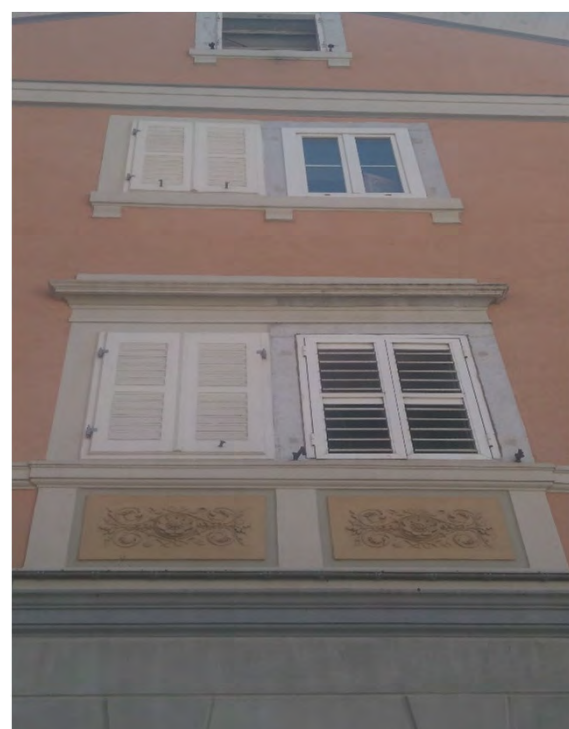
Particolare della coppia di persiane in malta. Al secondo piano l'assenza della persiana squilibra la lettura complessiva degli elementi decorativi (via San Michele 13 / facciata lungo la via della Cereria - 2019)
