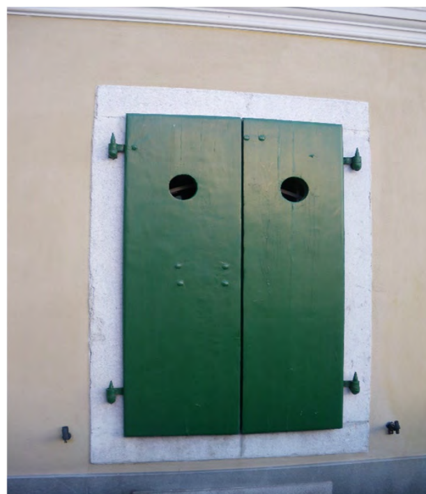
Portellone in legno verniciato; il tavolato presenta una foratura circolare per ciascuna anta la quale è sostenuta da un sistema di due cerniere per ciascuna anta (via dei Crociferi 3 - 2019).
