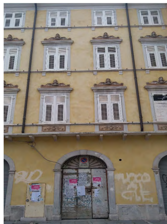
Rivestimento in intonaco liscio tinteggiato, ripartito da sottili cornici marcapiano in rilievo alla quota bancale dei vani finestra (piazza Cavana 5 - 2019)
