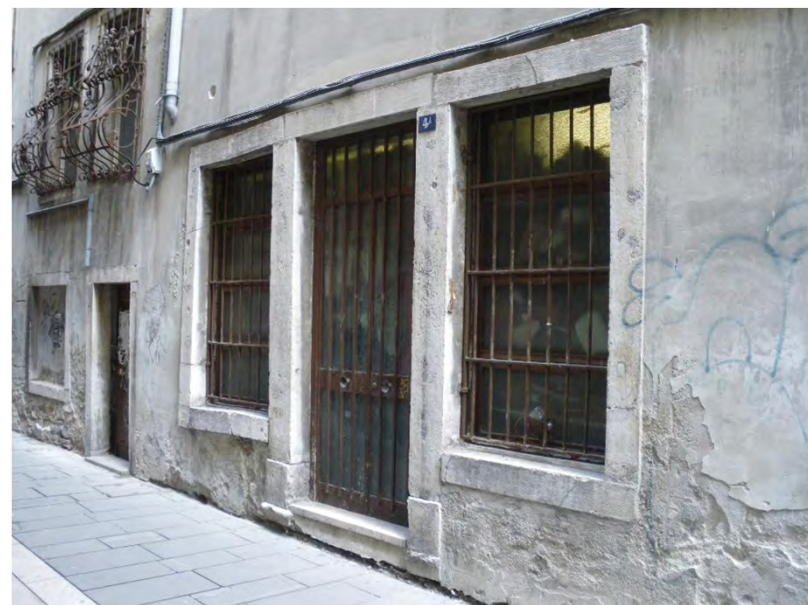
Rivestimento del basamento in intonaco liscio tinteggiato. Il trattamento superficiale è in continuità con il rivestimento dei piani superiori e parte dalla linea di terra (via delle Beccherie 4 - 2019)
