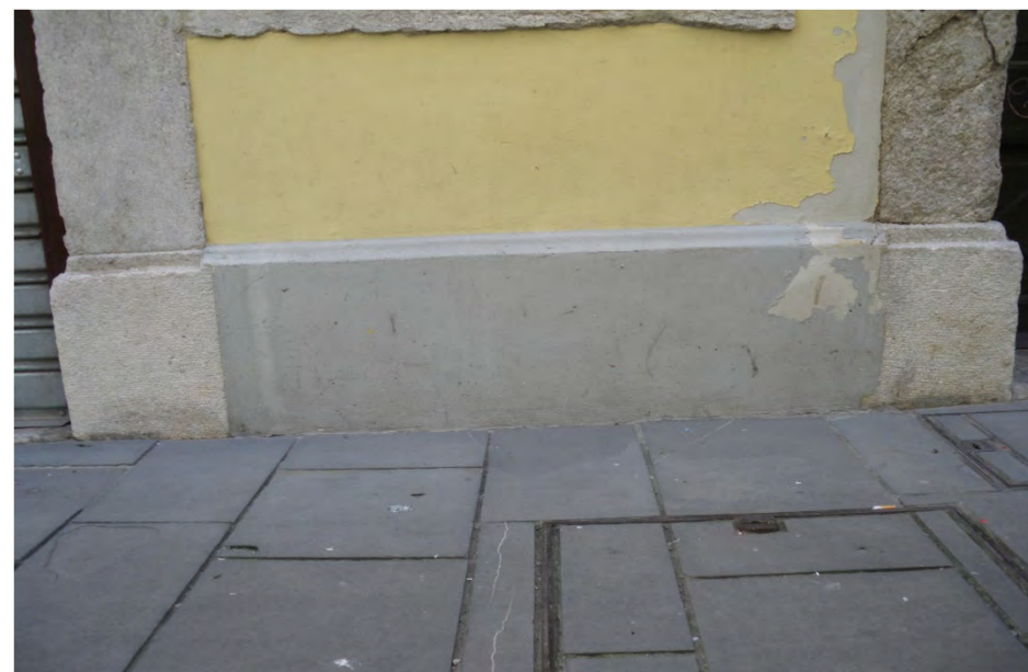
Zoccolatura a piani lisci in intonaco a forte spessore di circa cm 40 di altezza, inserita tra i piedritti degli stipiti delle aperture a piano terra realizzati in pietra (via delle Beccherie 8 - 2019)
