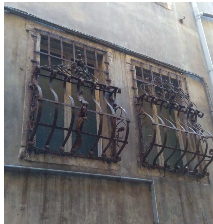
Coppia di griglie a sbalzo poste al primo piano (via delle Beccherie - 2019)
