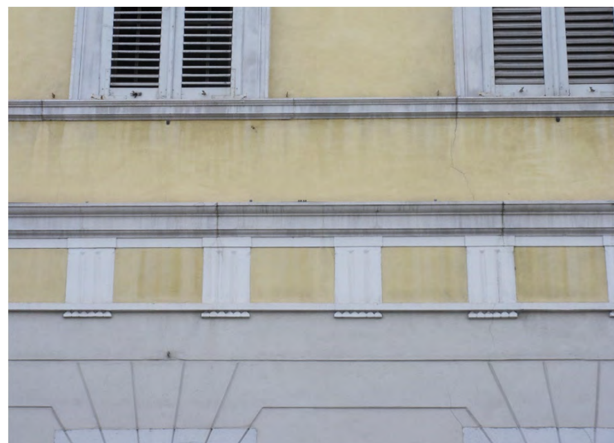
Fascia marcapiano definita da due cornici in rilievo e da decori intervallati dall'intonacatura che ne definisce la cadenza (largo Papa Giovanni XXIII n. 6 - 2019).
