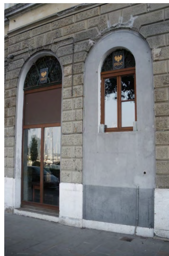
Finestra posticcia inserita in una foratura ad arco al piano terra. La riapertura del foro segue quello adiacente (riva Grumula 2 - 2019)
