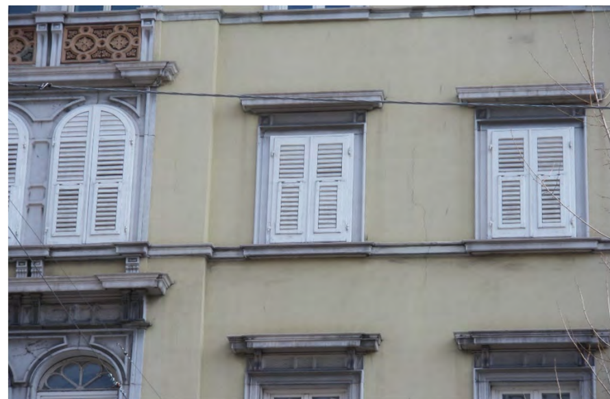
Fascia marcadavanzale in pietra a vista a piani lisci e con listelli perimetrali in risalto (via Battisti 10 - 2019)
