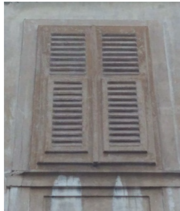
Particolare delle persiana in malta con cornice anch'essa in malta (via della Pietà 1 - 2019)
