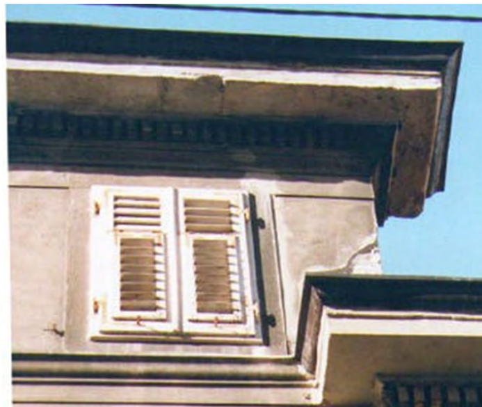
Cornice costituita da quattro elementi di pietra naturale a piani lisci. Si noti che l'architrave è inserita nella fascia sottocornice del coronamento (2001)
