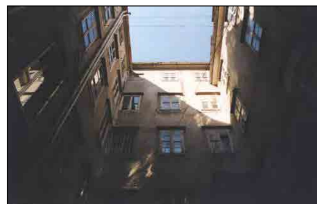
Corte interna (prima del risanamento)
