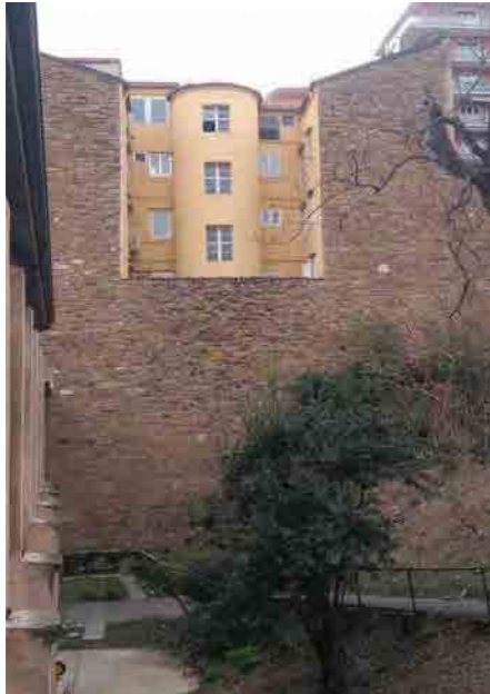
via della Cereria 13 - facciata postica con pianerottolo del corpo scala aggettante e semicircolare
