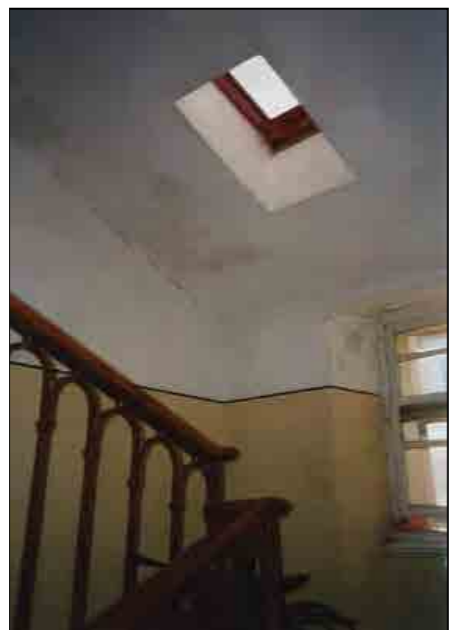
Degrado della copertura (vano scala)
