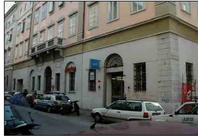
Alterazioni fori al piano terra
