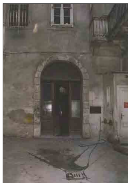
Corte interna (prima del risanamento)
