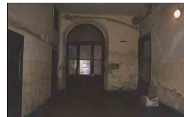
Androne d'ingresso (prima del risanamento)
