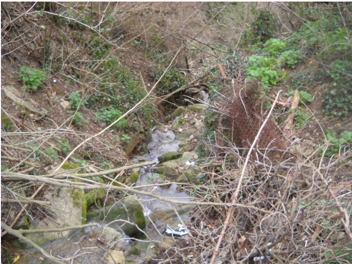
Tavola 48. Parte finale del torrente particolarmente esposta al degrado idrogeologico.
