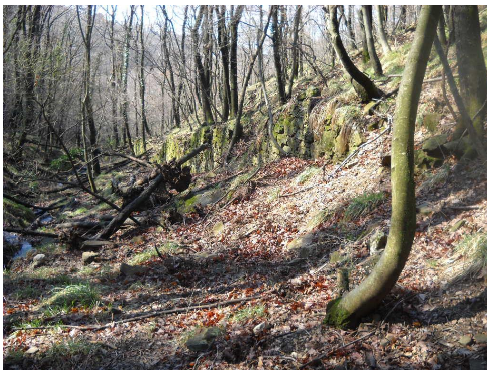
Tavola 38. Sponda destra, muretto in arenaria parzialmente collassato.
