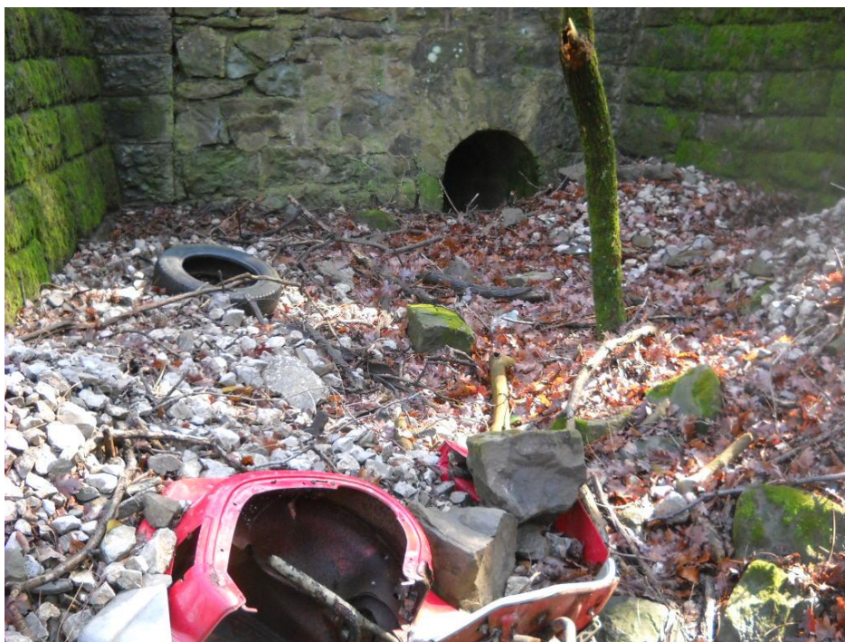
Tavola 36. Opera in galleria lato valle con parziale occlusione da materiale litico ferroviario.
