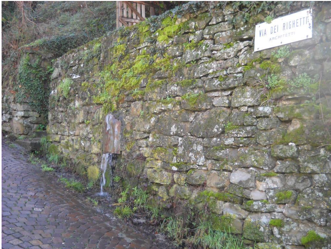
Tavola 40. Fuoriuscita di acque in pressione da un muro di pastino
